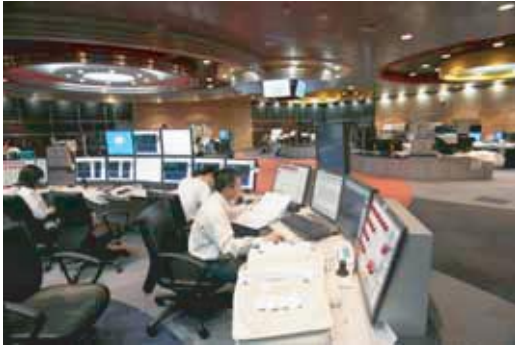
CSPS 南海项目的控制室
